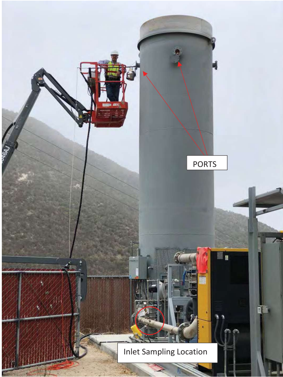
12.010 MMBtu/hr LOMPOC Flare S/N 2541
